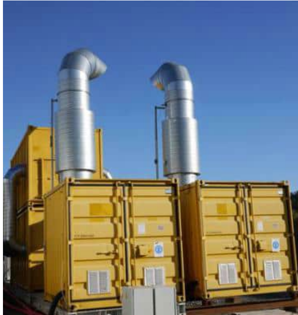
Extraction et traitement de l'air de la tente – silencieux sur cheminée
